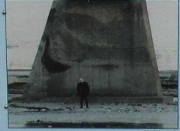
Mynd: Vaggarðinn Undirstöður brúa / Bridge foundations Brúar á Súlu, Gígukvísl og Skeiðarvötnu allar sönnu þar, stálþolabryr með timburdekk og stálþolun undirstöðum. Undirstöðum hvíta á 611 m löngum stöðum skilum 200 x 200 cm af brúanna sem myndu gá á sandinn. Brúar eru byggðar til 11 m hæðingun og er hver stöng löngum hlutum sem hveit er 44 m á lengd. Brúar eru hannaðar þannig að þó að einokk einn þrjú gæta aðrir einungis tólf kílómetra stáð afir af þar hafa ekki skemmdir. Hæðin á brúanna lita þá þá þá 0,3 m fyrir yfir 500, Gígukvísl og Skeiðar. Hæðin á brúnum var vafi þetta máli til að tryggja sem brottu þarinn og jökullaugum í Hlaupum gætu komist upp þar.
